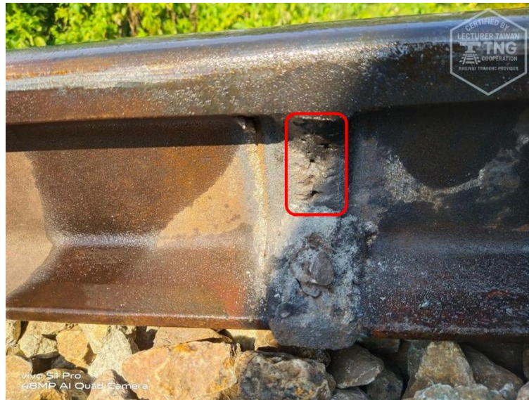
รูปที่ ง.3 รอยบกพร่องบนวงรอบรอยเชื่อม (surface defaces in the weld collar)
