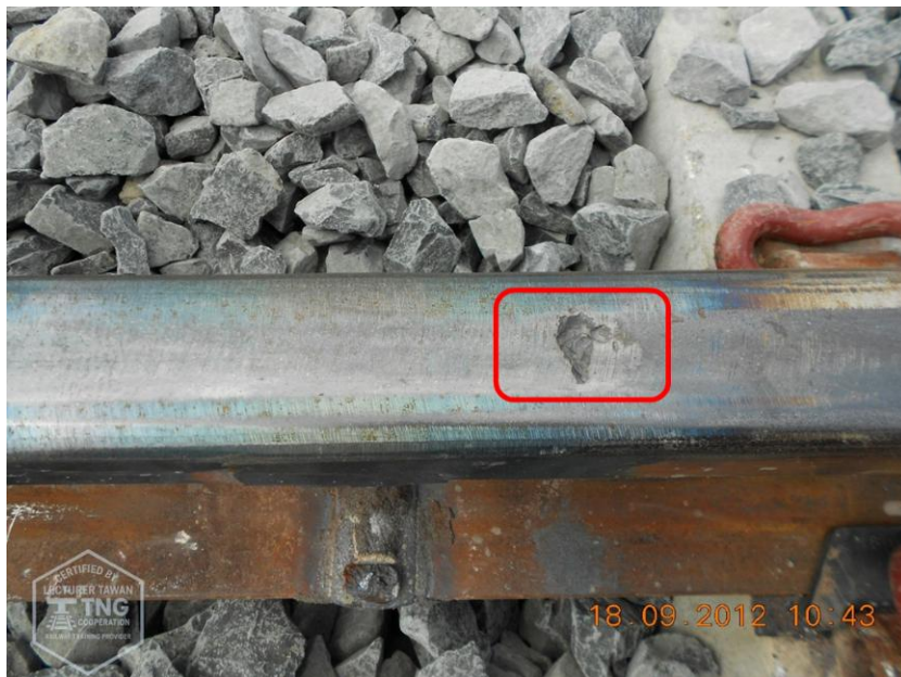
รูปที่ ง.6 รอยฉีกตามขวางของรอยเชื่อม (transversal tearing of surface weld material)
